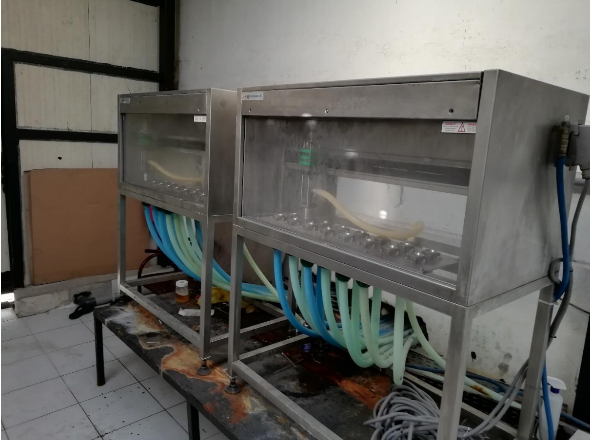
Şekil 2.3 Çok Hatlı Sıvı Kimyasal Dağıtım Sistemi: Çok Hatlı Transfer
