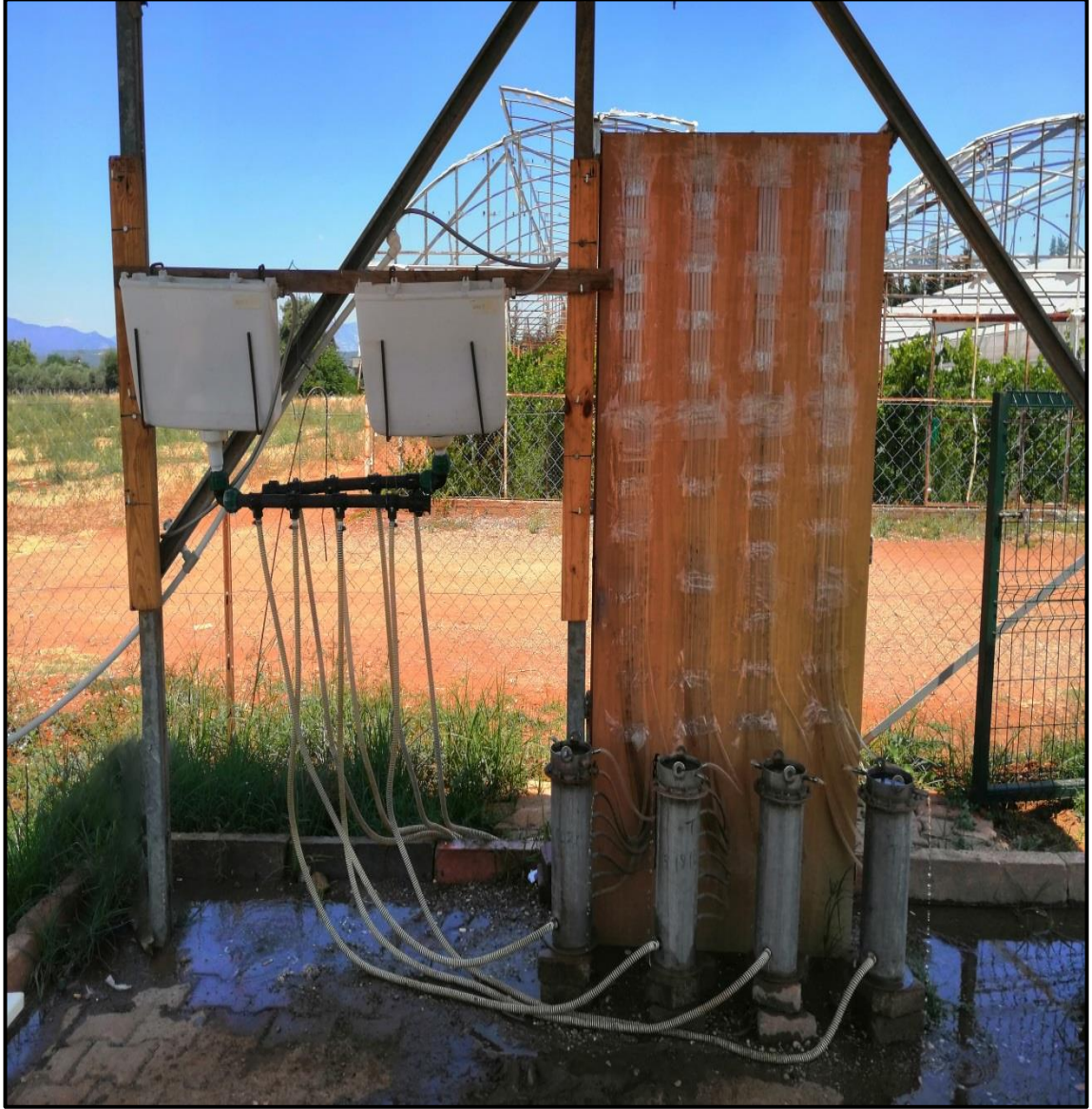
Şekil 3.2. Permeametre düzeneğinin kurulumu ve tesviyesi
