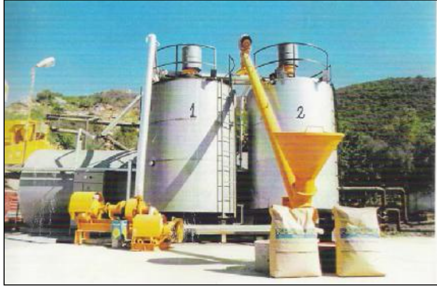
Şekil 3.3. Modifiye Bitüm Tesisi
