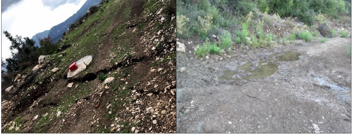
Şekil 4.11. Sol yamaç şev tepesi üzerinde gelişen çatlaklar ve su çıkışı
