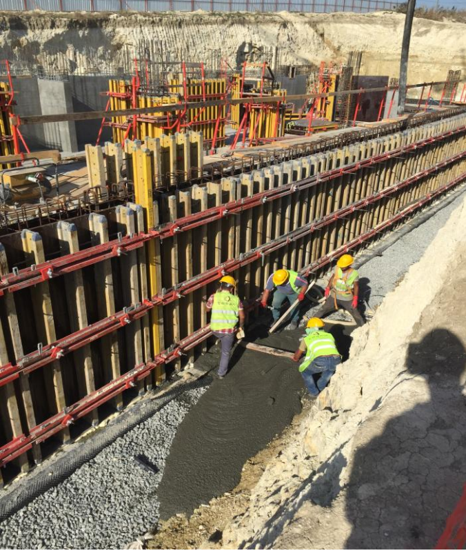
Şekil 4.5. Kalıp açması sonucu oluşan beton zaiyatı
