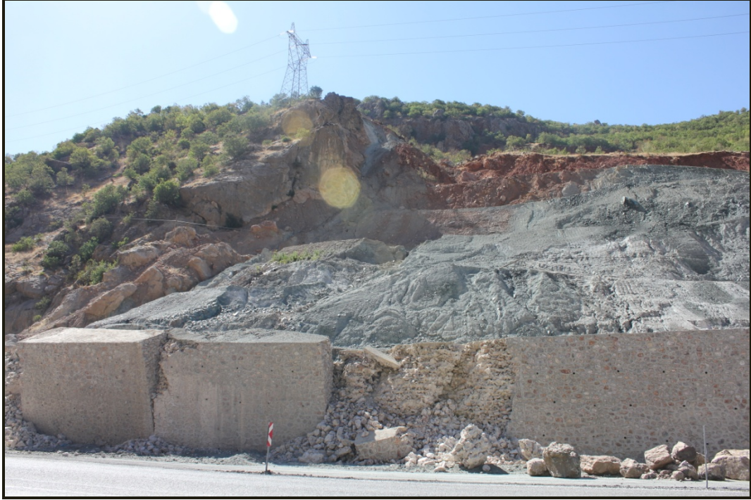
Şekil 4.69. Bitlis-Diyarbakır karayolunda Guleman ofiyolitlerinde serpantinitlelerin neden olduğu heyelan ve yıkılan istinat duvarı
