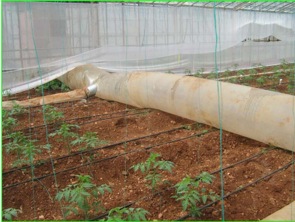
Şekil 3.10. Sera içerisinde sıcak hava üfleli ısıtma sistemi
