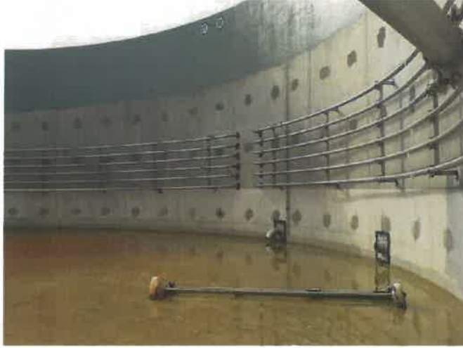
Şekil 4.53. Biyogaz tesisi fermentör içi ısıtma sistemi
