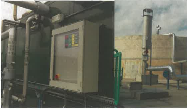
Şekil 4.51. Biyogaz tesisi gaz kontrol hatları.
