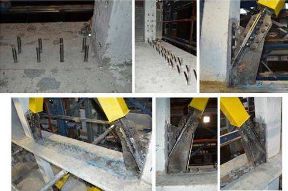
Şekil 3.18. Kolon-kiriş düğüm noktasındaki bağlantı detayı (TÜBİTAK 112M820 nolu projenin sonuç raporundan alınmıştır.)
