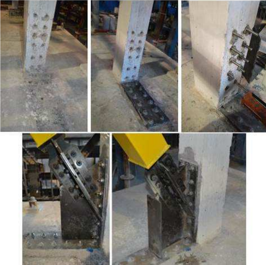
Şekil 3.16. Kolon-temel birleşim noktasındaki bağlantı detayı (TÜBİTAK 112M820 nolu projenin sonuç raporundan alınmıştır.)
