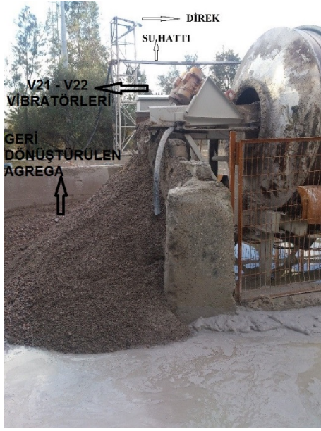
Şekil 2.13. Agreganın geri dönüşüm sistemi çıkış vibratörleri ve su hattı
