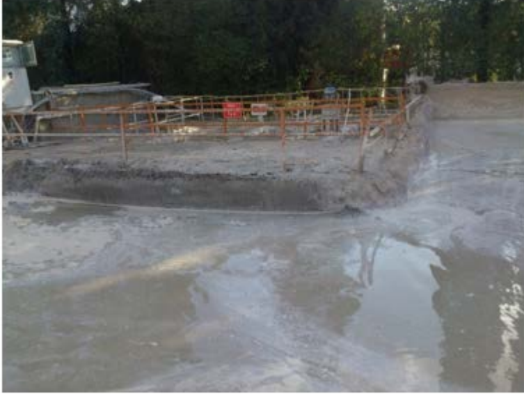
Şekil 2.9. Santral gezisinde çekilen çökeltme havuzu
