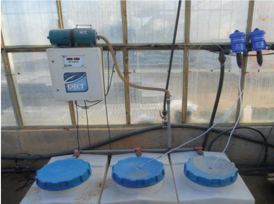
Şekil 3.5. Zaman ayarlı dosatron injeksiyonlu sulama ve gübreleme otomasyon sistemi ve kontrol panosundan bir görünüm
