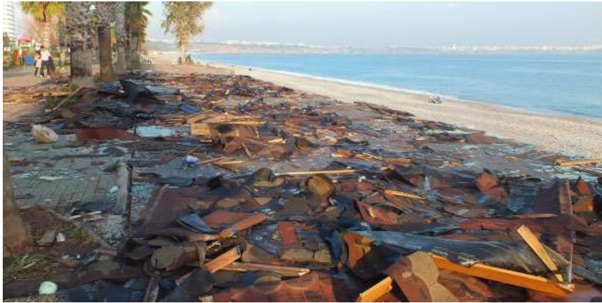
Şekil 4.7. Konyaaltı Batı Plajlarının yıkımdan sonraki durumu (Anonim 2013g)
