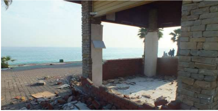
Şekil 4.6. Konyaaltı Batı Plajları'nın yıkımdan sonraki durumu (Anonim 2014f)
