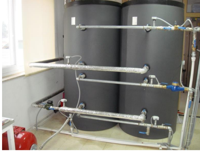
Şekil 3.4. Depo ve bağlantıları
