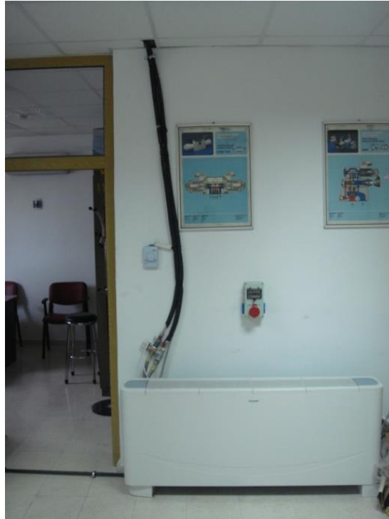
Şekil 3.5. Laboratuvar ortamında kurulan fan-coil fotoğrafı
