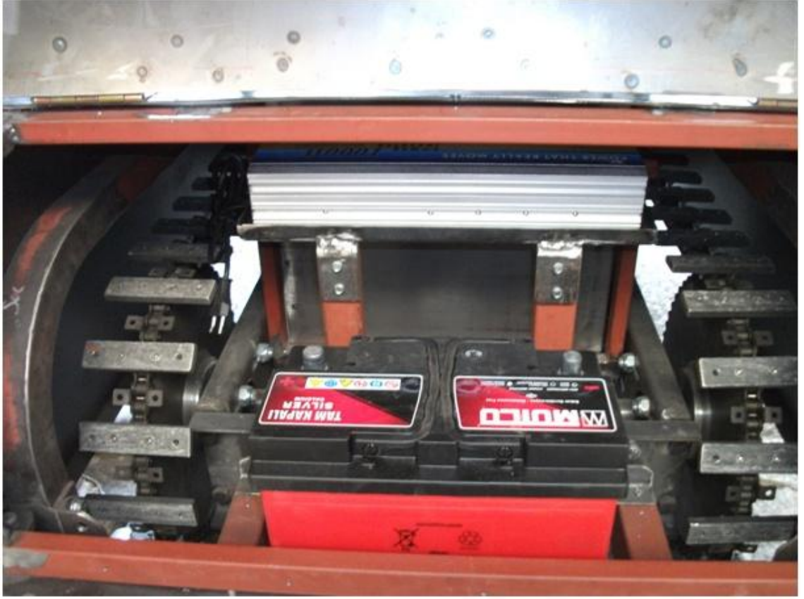
Şekil 3.18. Inverter ve akünün robot üzerindeki yerleşimi
