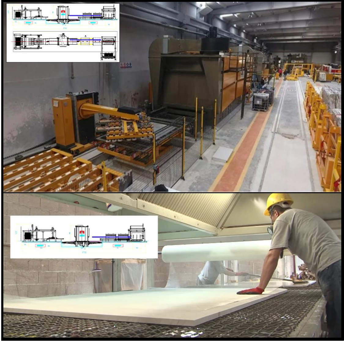
Şekil 3. 10. Mermer levhasına epoksi uygulamadan önce fırınlarda kurutması ve sonra mermer levhasının arka yüzeyine epoksi reçinesi ile fileleme işlemi uygulaması
