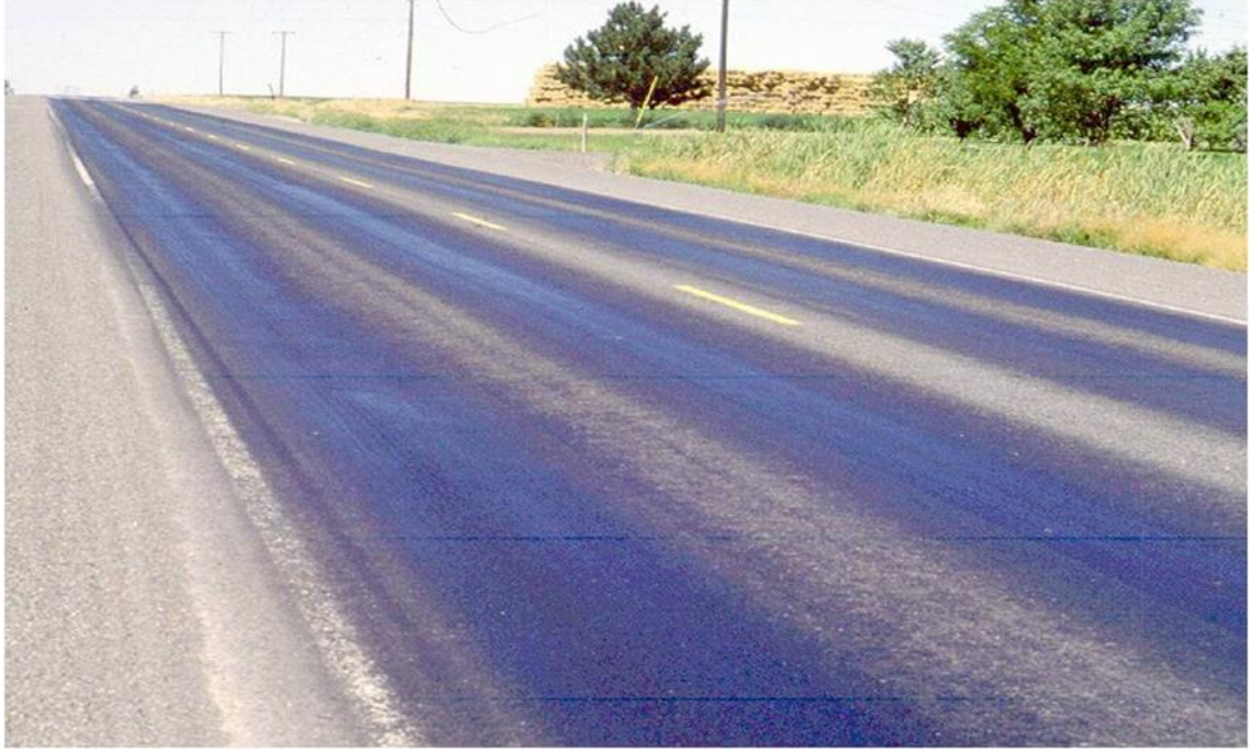
Şekil 2.20. Kusan Asfalt (Bleeding Asphalt)
