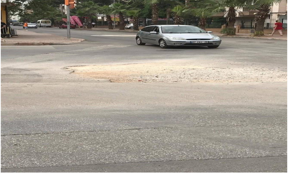
Şekil 4.15. (4) Etiler Mahallesi Koroğlu Caddesi
