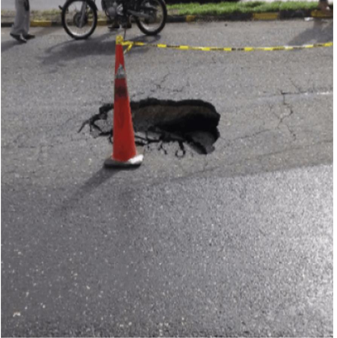
Şekil 2.13. Yerel Çökme ve Ötelenme (Shoving)
