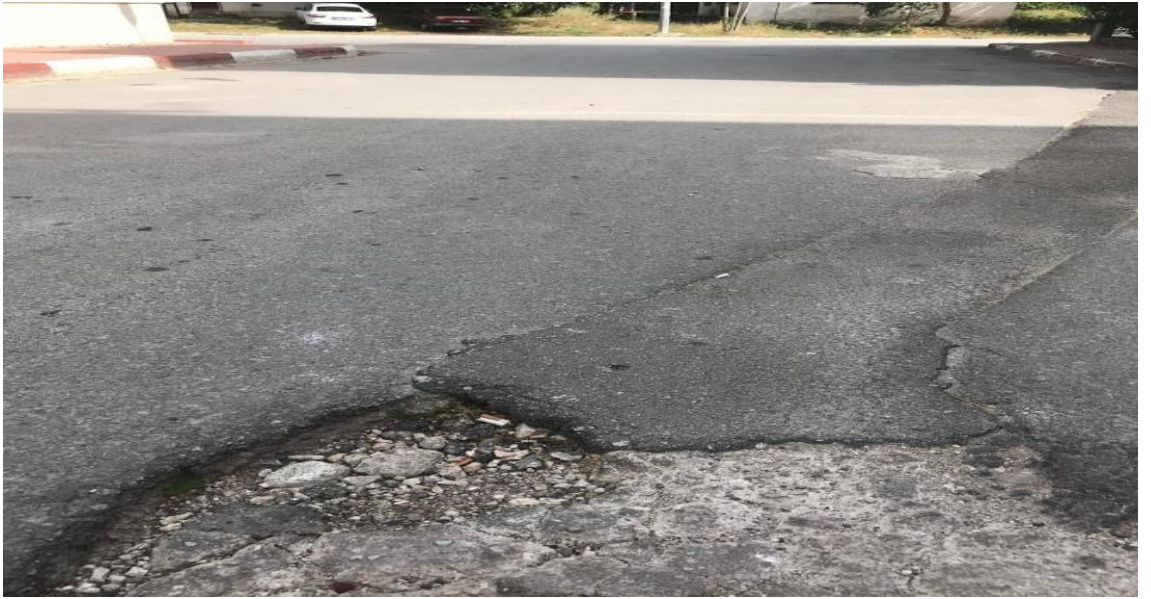
Şekil 4.20. (9) Çaybaşı Mahallesi 1358 Sokak
