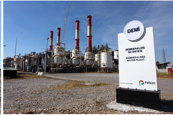
Resim 2.6 Demineralize Su Ünitesi Tesisi Levhası
