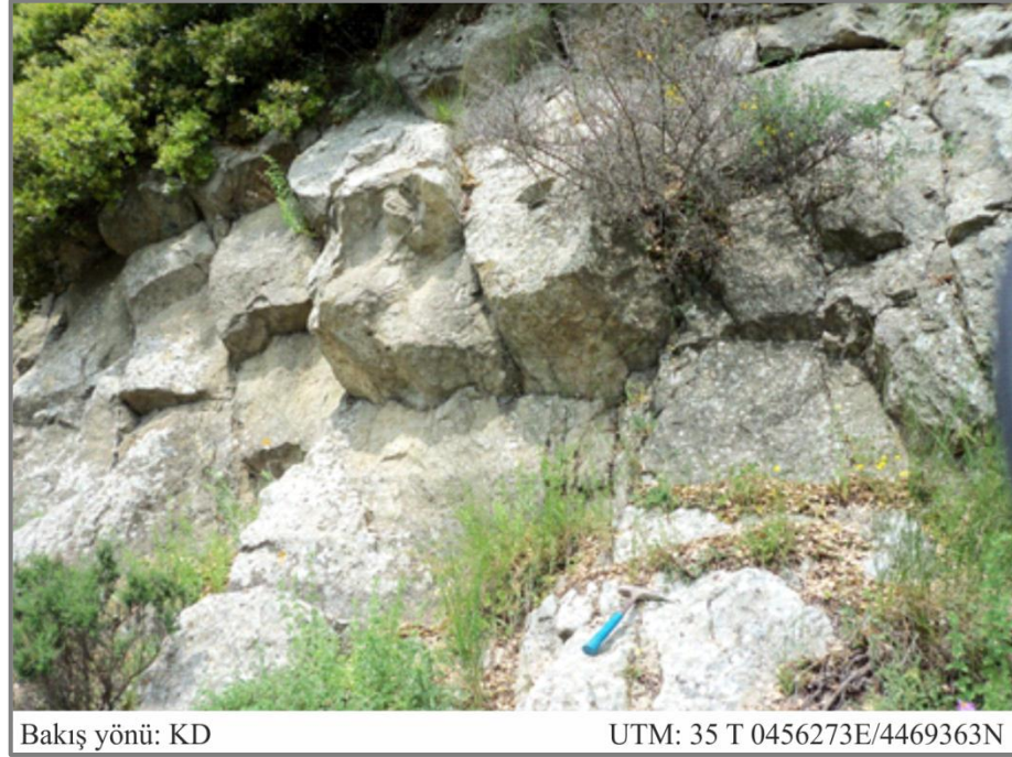
Şekil 4.10. Sık çatlak yapısı gösteren porfiri andezitler.
