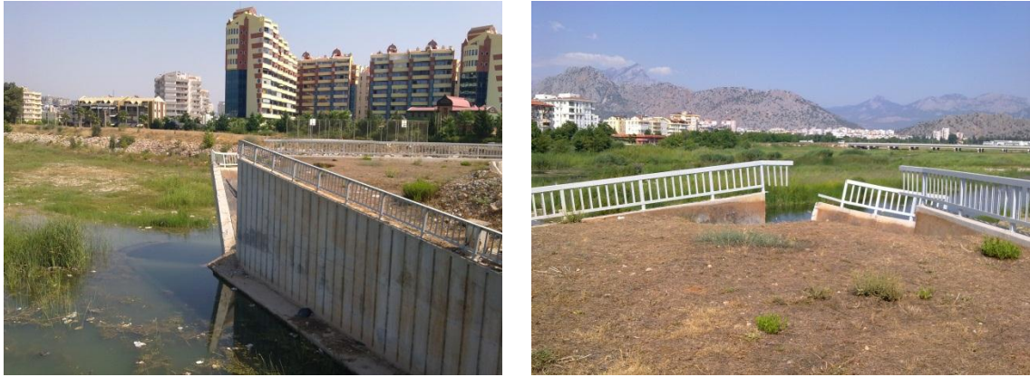
Şekil 5. 8. Boğaçay köprüsü ayağında bulunan istinat duvarında 2011 yılında yaşanan çökme (Orjinal 2011)
